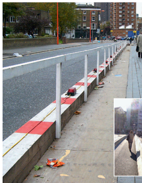
Baustelle und Café haben nicht zugleich Platz (oben links), mit Pfeil wird nicht als Umleitung verstanden (klein: vers...
